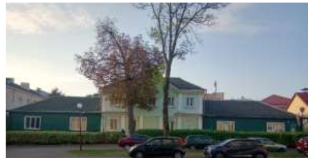
Малюнак 1. Фасад будынка на завулку Тэлеграфны, 2, г. Гродна. Фотаздымак аўтара. Працы праходзяць на гарышчы правай драўлянай прыбудовы.
